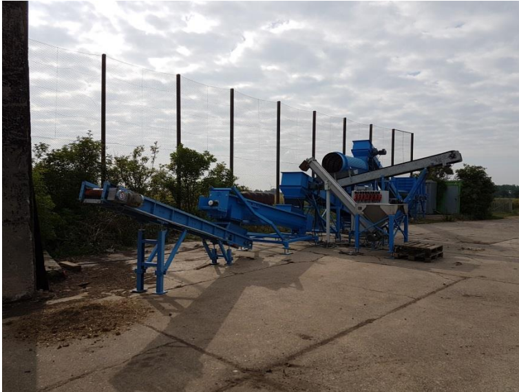
Abbildung 1: Standort Bodenbehandlungsanlage am Standort Thronitz
